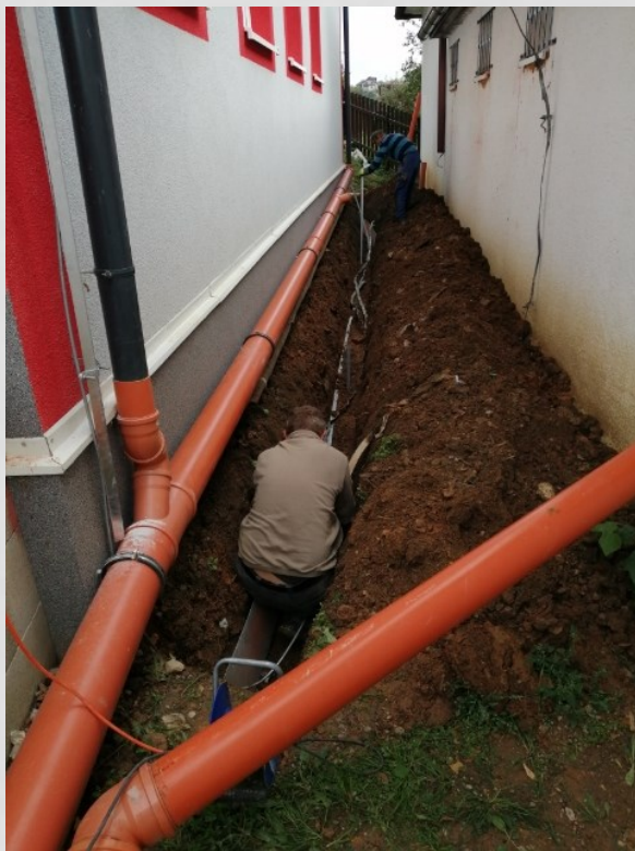
Bleskozvod na Hasičskej zbrojnici
